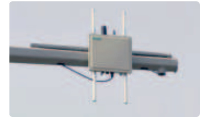
شكل 7.6: وحدة الاتصال على جانب الطريق (RSU)
